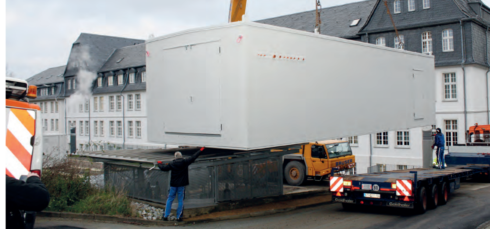
Im Dezember 2014 wurde auf dem EnergieCampus in Goslar der Versuchsstand für Aufladesysteme der Leibniz Universität Hannover errichtet.
